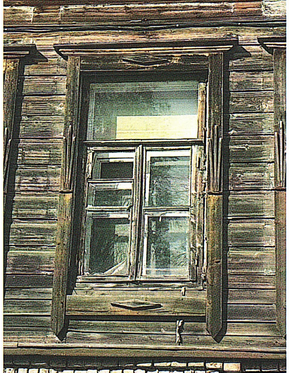
Рис.14. Сохранившиеся деревянные рамы
