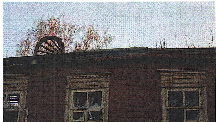
Рис. 8-9. Крыша здания (утрачена), сохранены конструкции слухового окна
