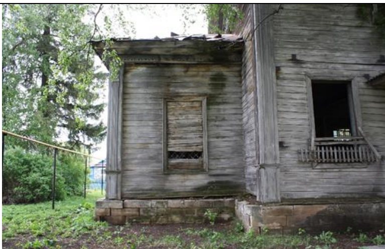
10 нчы рәсем. Табигый таштан ясалган эре блоктардан өелгән нигез. Төнъяк фасад фрагменты
