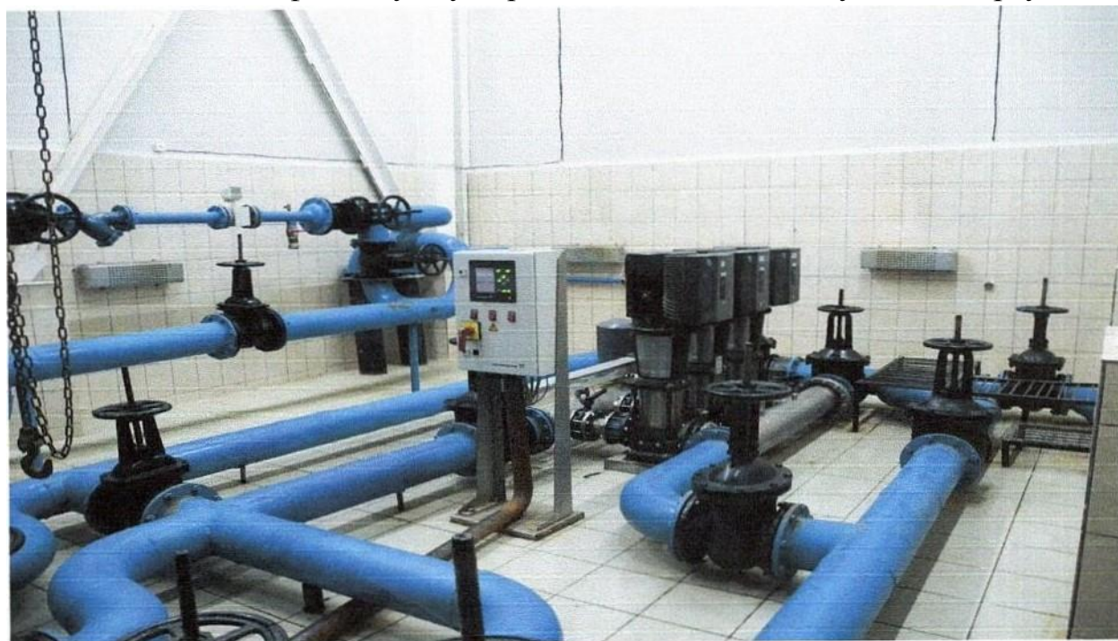
4 нче фото. Насос станциясе (2 күтәрү).
