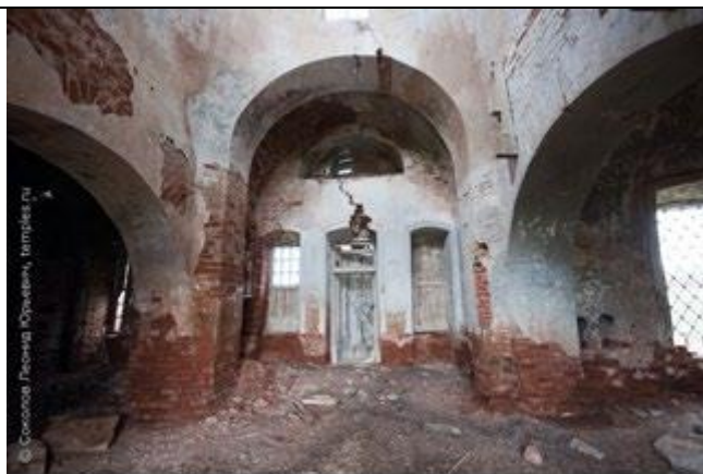
Чиркәүнең беренче ярусының интерьер ягыннан тәрәзә һәм ишек уемнарының нурлы тоташтыргычлары, 1 нче кат тоташтыргычлары
