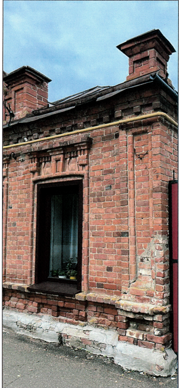
Рис.11. Оконный проем с замковым камнем и сандриком. Парапетная тумба. Кирпичная кладка
