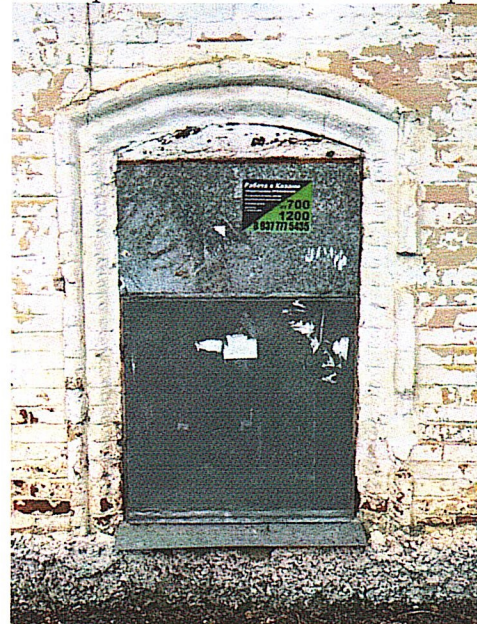
Рис.14. Характер и состояние красочного слоя, столярного заполнения оконных проемов.
