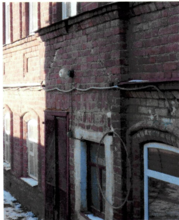
Рис. 18. Оформление утраченной входной группы (следы двускатного навеса (утрачен); перекладка дверного проема в оконный)
