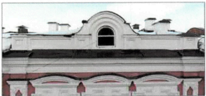
Рис 11. Атик с квадратными и прямоугольными перспективными нишами и полуциркульным оконным проемом в тимпане; кирпичные выпуски труб; венчающий карниз; лучковые сандрики центральной трехосевой раскреповки фасада (окна балкона); фланкировка раскреповки пилястрами с нишами с изломами в углах и полукружиями
