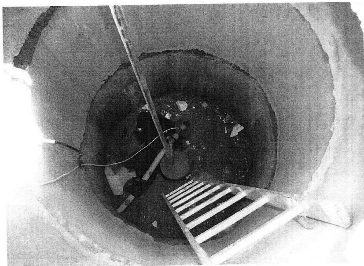
Рис. 1. Санитарно-техническое состояние скважины
