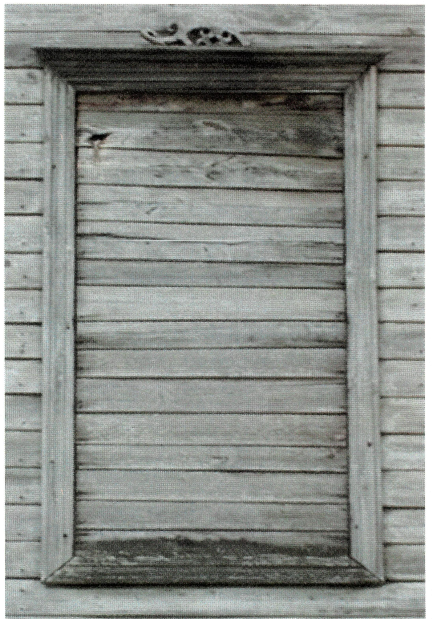
Рис. 25. Рамочные профилированные наличники в обрамлении оконных проемов трапезной, с сандриками в виде профилированных полочек и прорезных декоративных элементов над ними (частично утрачены)
