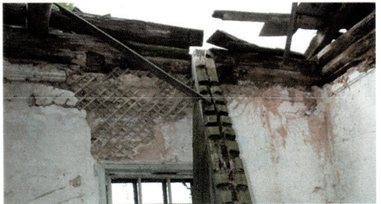
Рис. 14. Плоские деревянные перекрытия в трапезной (частично утрачены). Гнезда от балок перекрытия
