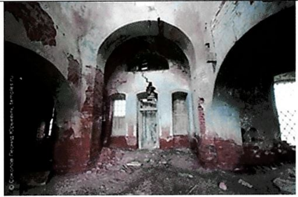
Лучковые перемычки оконных и дверных проемов первого яруса храма со стороны интерьера, арочные перемычки проемов 1-го этажа
