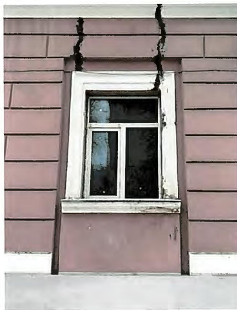
Оконный проем первого этажа углублённое в нишу
