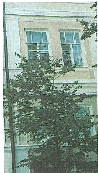
Историческая расстекловка окон третьего этажа
